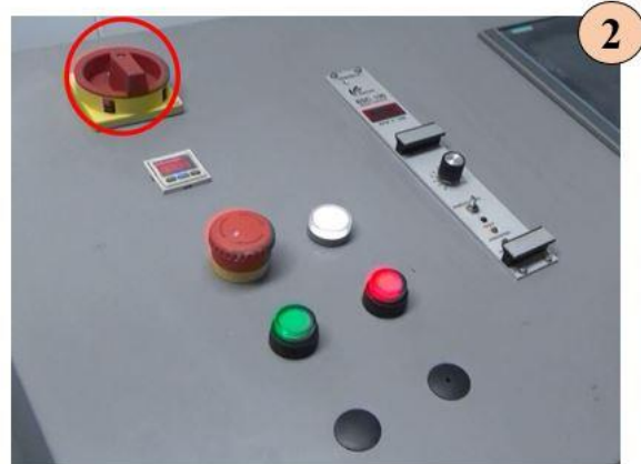
2) ดำเนินการเปิดสวิตช์ที่แผง Controller
