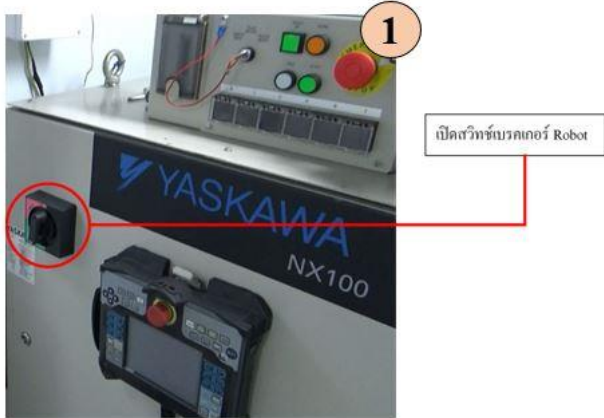
1) เมื่อจะทำการเปิด Robot ขึ้นแรกก็ให้ทำการเปิดสวิตช์เบรกเกอร์ที่ตู้ควบคุม Robot
